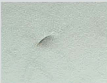
Deformarea materialului, taieturi, rupturi sau murdaria extrema.
